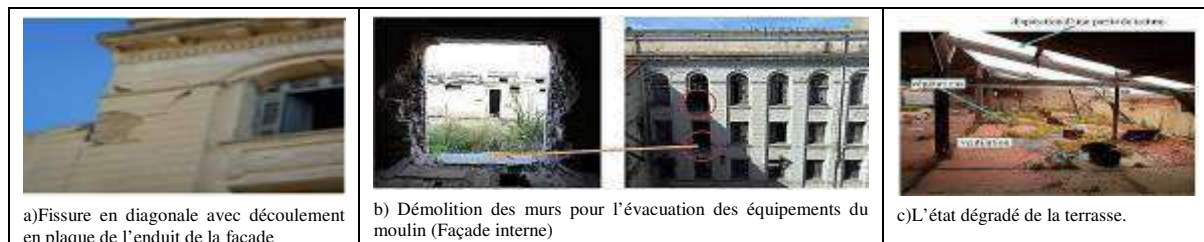
Figure.3 Désordres constatés dans de différents niveaux du bâtiment.
