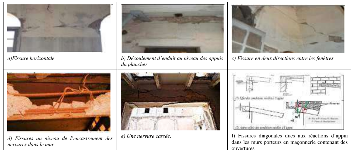
Figure.2 Désordres dans les murs porteurs en maçonnerie et dans les planchers. [4]
