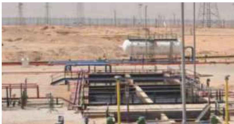
Fig. 1. Station de déshuilage API- CINA (Vue externe).
